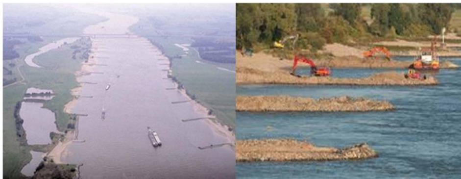
Hình 1. Kè mỏ hàn trên sông Waar, Hà Lan [1].
